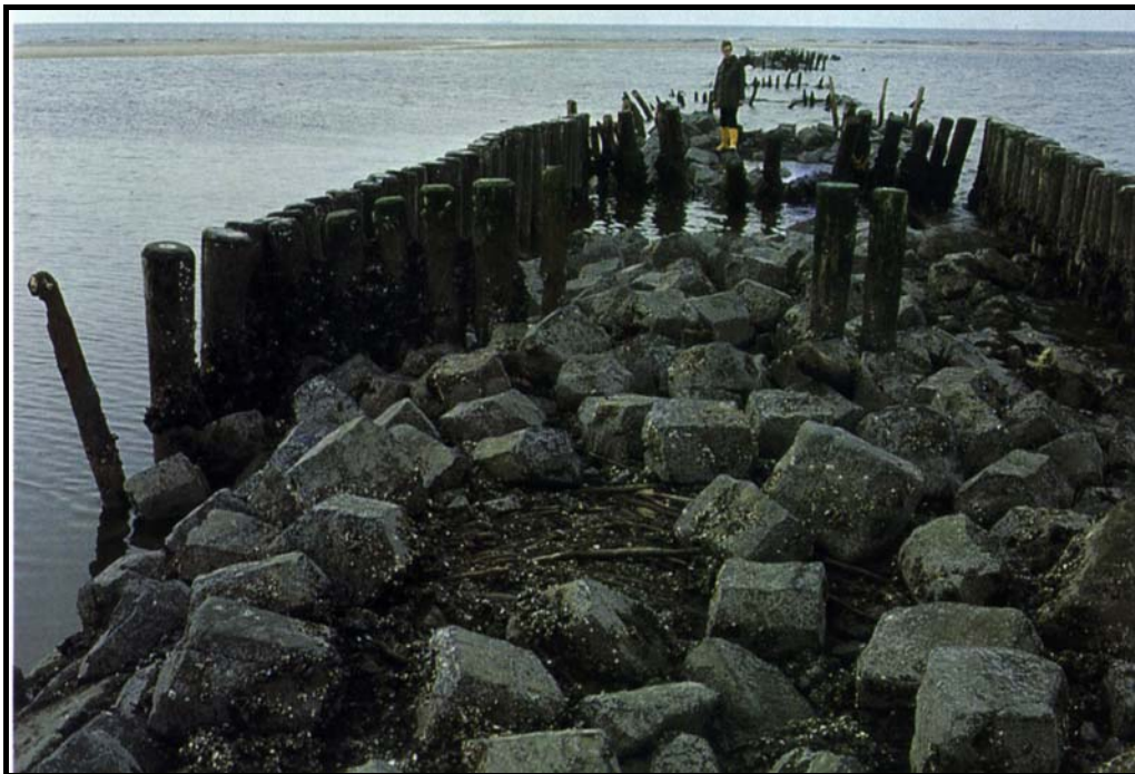
Abb. 3.10: Beschädigte Buhne auf Wangerooge (1979). Quelle: EHLERS 1988
