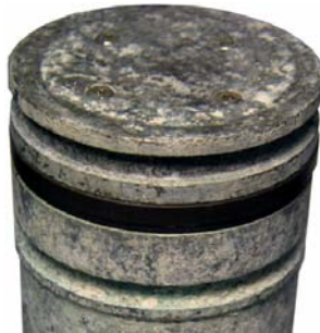
Abbildung 3.5: Erhebliche Korrosion am ursprünglich aus Aluminium gefertigten Hubkolben aus der Antriebseinheit der Messanlage.
