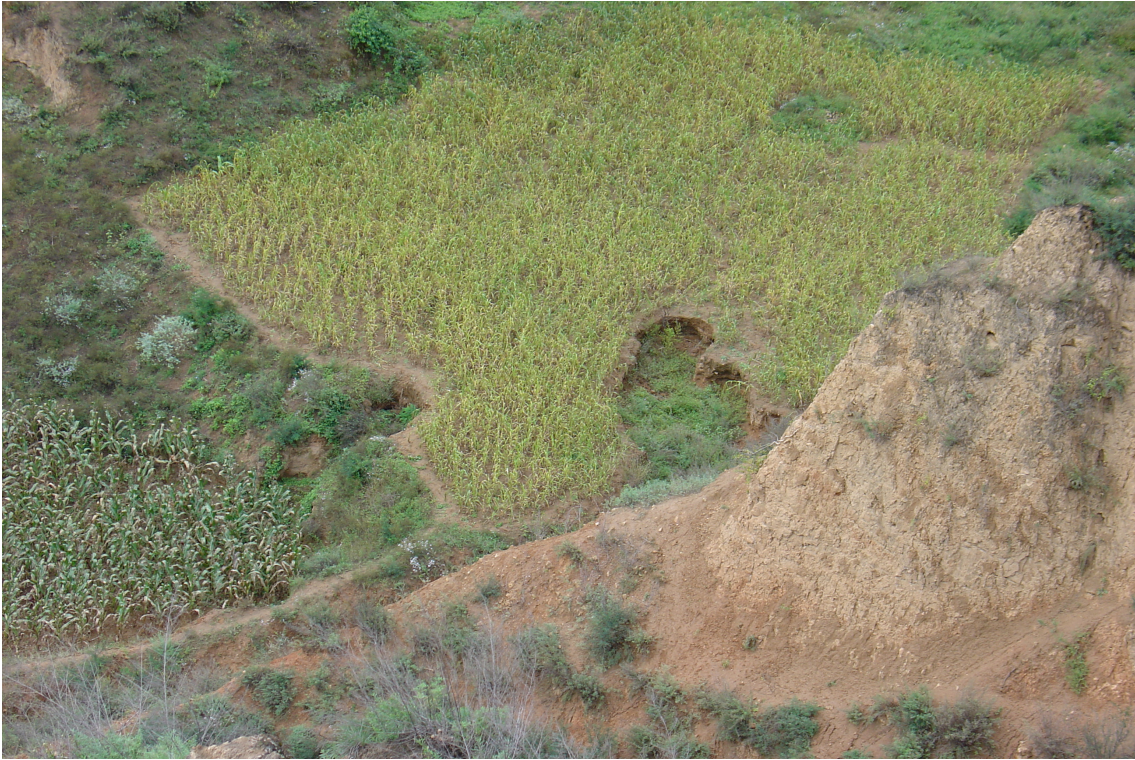
Abb. 17: Unterirdische Erosion am südlichen Verlandungsdamm des Reservoirs X in Yangjuangou. Foto: BORK 2003
