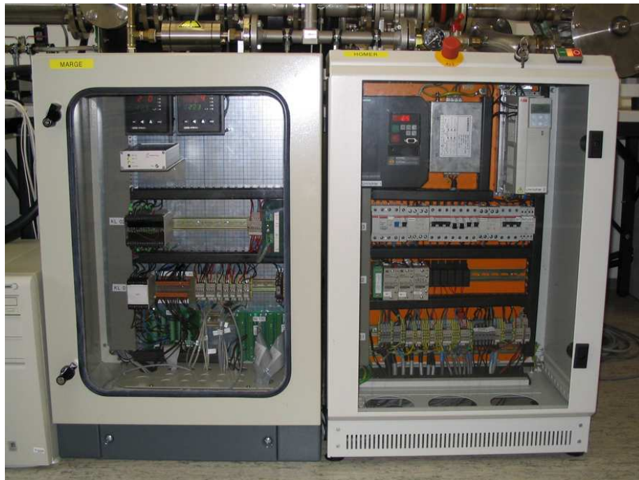
Abb. B.6: Durchflussmessstrecke – Schaltschränke
