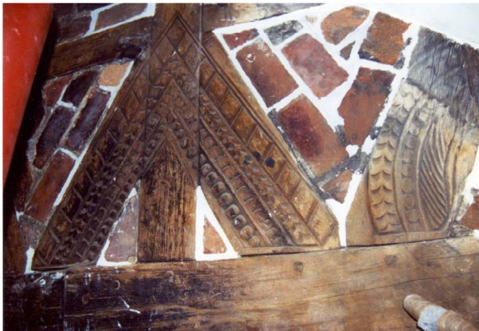
Abb. 97 Obere Ohlingerstraße, 1593 (i), N-W-Traufwand innen, unter dem Dach des Treppenhauses, Verlauf des vorherigen Daches rechts ablesbar (Verwitterung)
