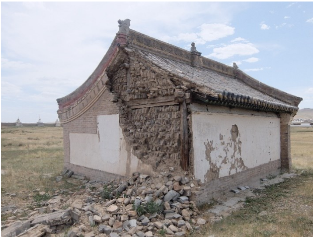
Abbildung 50: Ein kleiner Tempel in chinesischem Baustil im Bereich des Klosters Erdene zuu. Die eingestürzte Wand lässt das Verhältnis der tragenden Skelettkonstruktion und der sie einfassenden Wände gut erkennen (Foto: Autor).
