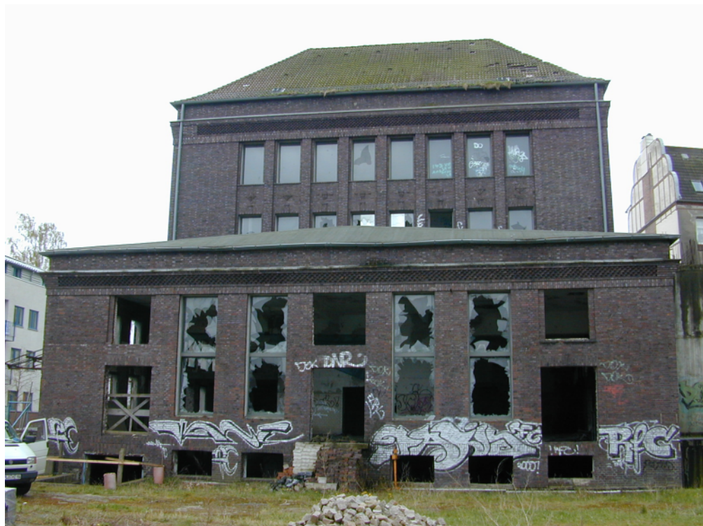
Abb. 262 (Kat. 78) Milchhof, 2002, nach jahrzehntelangem Leerstand (Foto 2002)
