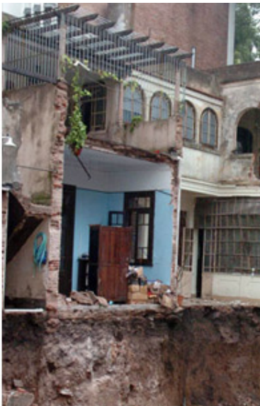
Abb. 12: Hauseinsturz in Caballito Quelle: La Nación 27.03.2007
