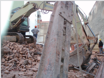
Abb. 23: Illegaler Abriss der denkmalgeschützten Casa Benoit Quelle: Basta de Demoler 2010
