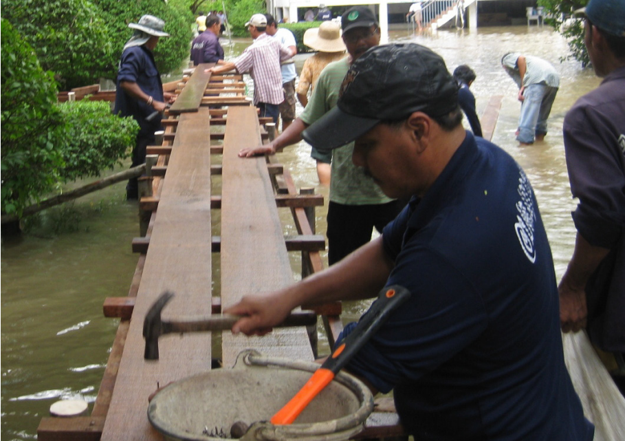
Abb. 48: Aufbau der temporären Gehwege in Ban Lad Kret vor dem Hochwasser von 2011 Quelle: Eigene Aufnahme 2011
