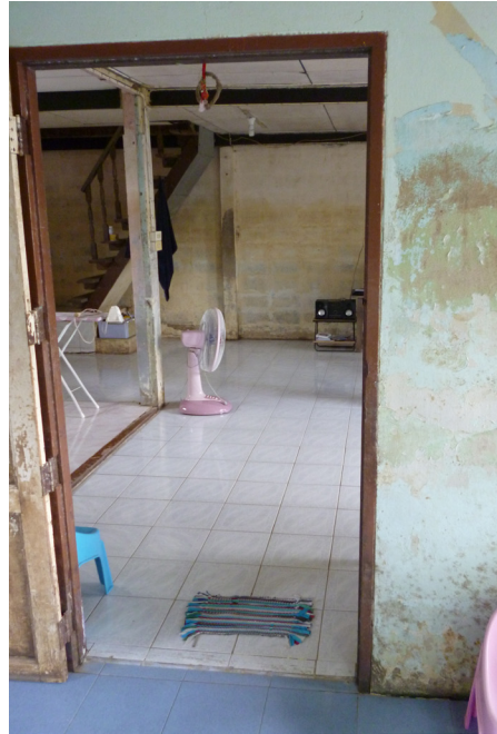
Abb. 36: Das Hochwasser von 2011 hat deutliche Spuren an den Wänden dieses modernen Hauses in Ban Lad Kret hinterlassen
