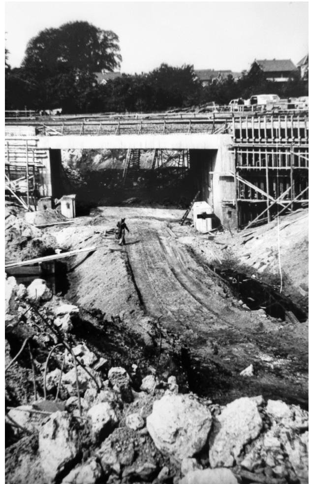
Abb. 30: Der Tunnel in der Bahnhofstraße im Bau. Nach langer Planung im Jahr 1981 eingeweiht, machte der Tunnel den beschränkten Bahnübergang obsolet und sorgte für eine Entspannung der Verkehrssituation im Bereich des Bahnhofs. Alle Rechte vorbehalten. Quelle: KVBL.
