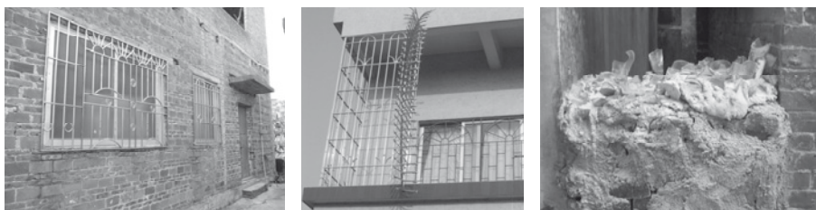
Abb. 86: Bauliche Maßnahmen zum Schutz vor Einbrüchen (eigene Aufnahmen 2008 und 2009)
